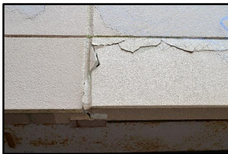
天井の壁が破損し落下する危険な状態です。
