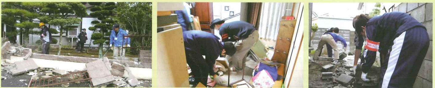
東日本大震災時の高齢者世帯などの被災者宅のブロック塀・室内の片づけの様子
